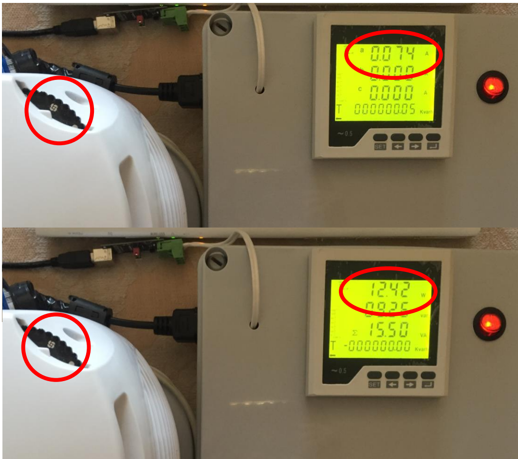
Ilustración 48: Valores medidos por el prototipo con la calefacción regulable en ventilación.
