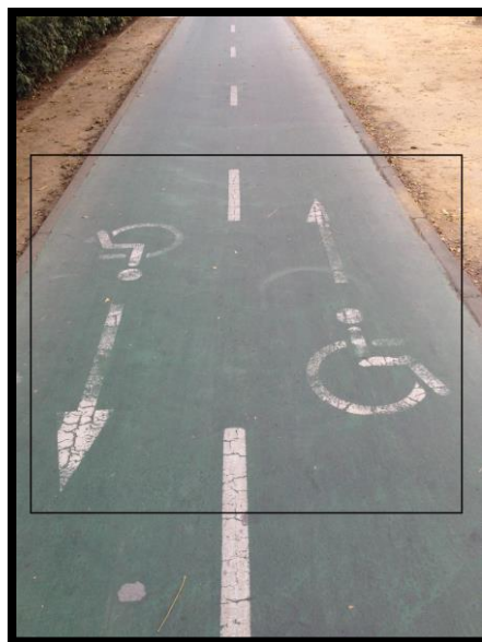
Figura 8: Degradación similar en ambos carriles
