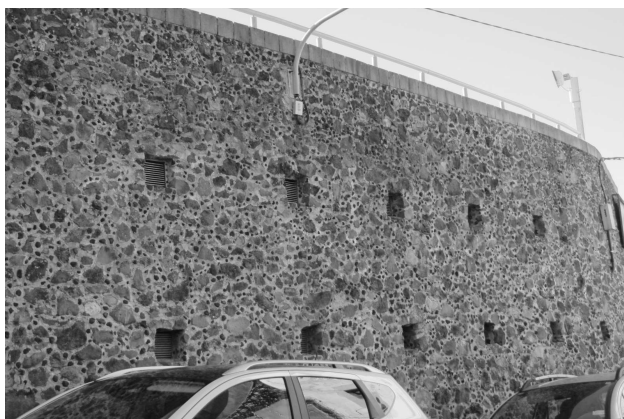
Fig. n.º 17.- Detalle de las aspilleras abiertas en el muro de la plaza en 1874. Autor: Julio Clavijo Ledesma. 2013.
