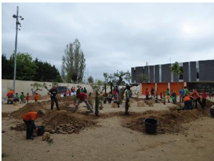
Fotografías de distintos colegios regenerados gracias a la participación ciudadana bajo el proyecto Patis Escolars Oberts al Barri .
