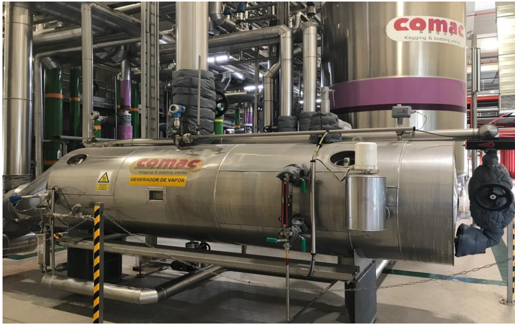
Figura 3-13. Generador de vapor a alimentar con el agua extrablanda caliente procedente de la recuperación de calor sensible del circuito de frío.
