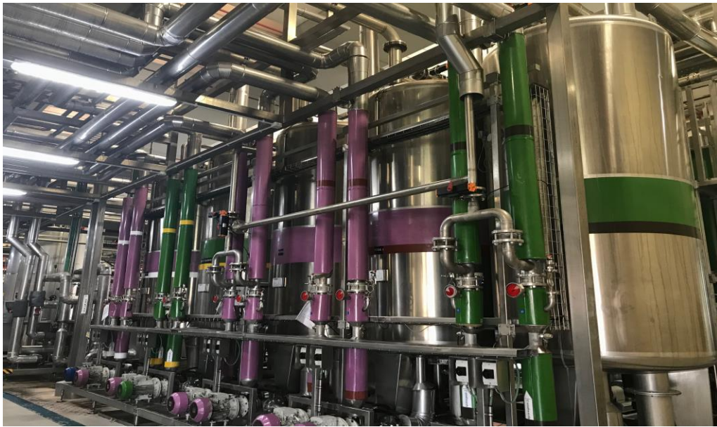
Figura 3-12. Ejemplo de tanques de envasado limpiados con agua blanda calentada gracias a la recuperación de calor latente del circuito de frío.
