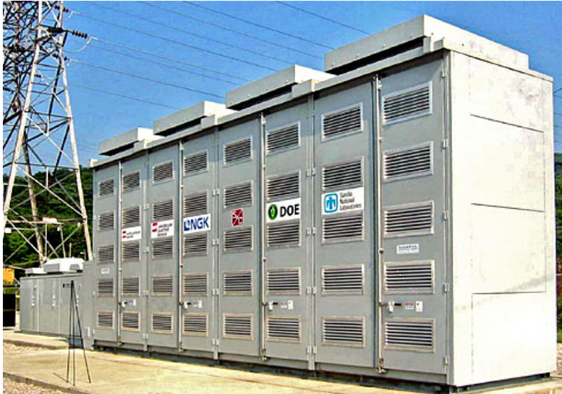
Figura 2.18 Batería de sulfuro de sodio en generación.
