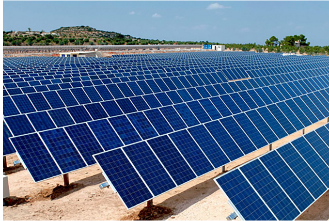
Figura 3.7 Parque de generación fotovoltaica.
