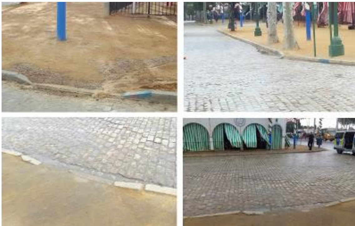
Pie de Foto. Imagen cedida por la Asociación Eliminando Barreras. Rebajes inadecuados para las personas con movilidad reducida en el recinto que componen la Feria de Sevilla.
