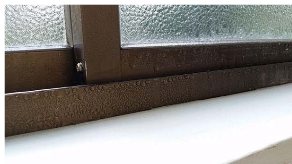
Img 47. Carpintería con condensaciones. Fuente: http://www.google.com
