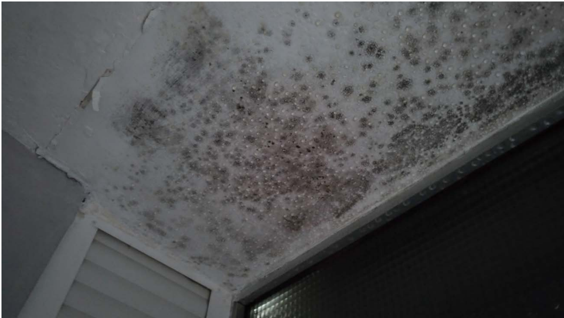
Img 50. Humedades por filtraciones en la cubierta. Ed: Elaboración Propia.
