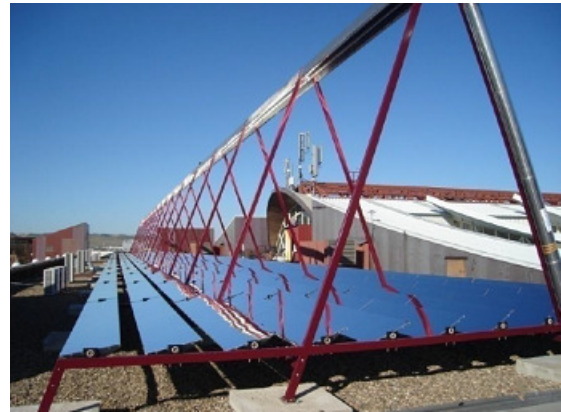
Fig. 3. Captador Solar Fresnel de la PRS [8]
