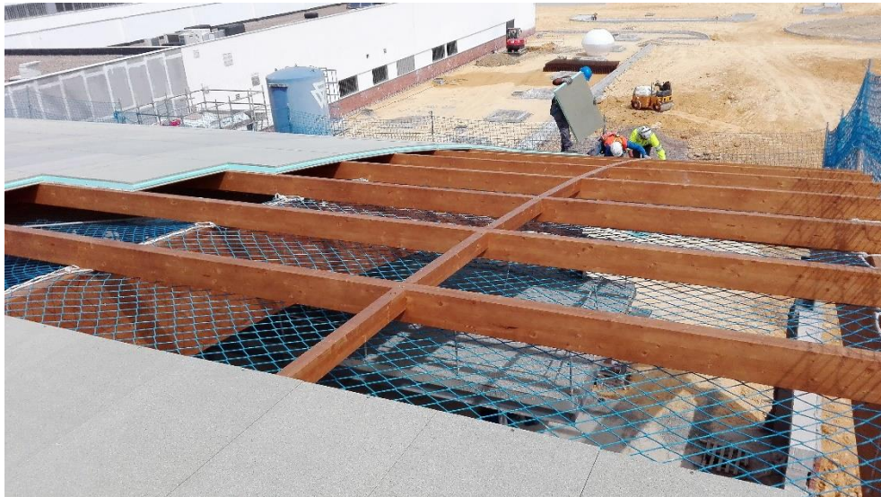
Ilustración 20 – Vista 2 colocación de paneles tras varias m2 ya ejecutados. Capilla CEU Bormujos, Edificio objeto de estudio. Fuente: Elaboración propia.
