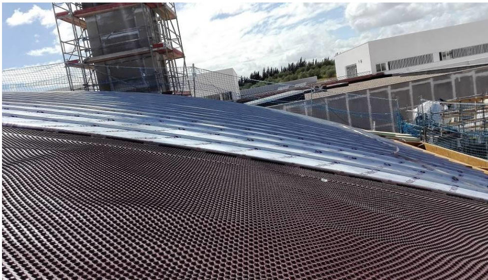
Ilustración 24 - Vista cubrición con lámina nodular finalizada. Capilla CEU Bormujos, Edificio objeto de estudio. Fuente: Elaboración propia.
