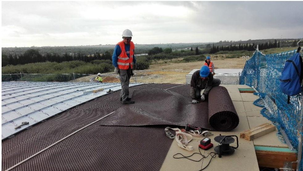
Ilustración 26 - Vista despliegue de rollo de lámina nodular. Capilla CEU Bormujos, Edificio objeto de estudio. Fuente: Elaboración propia.
