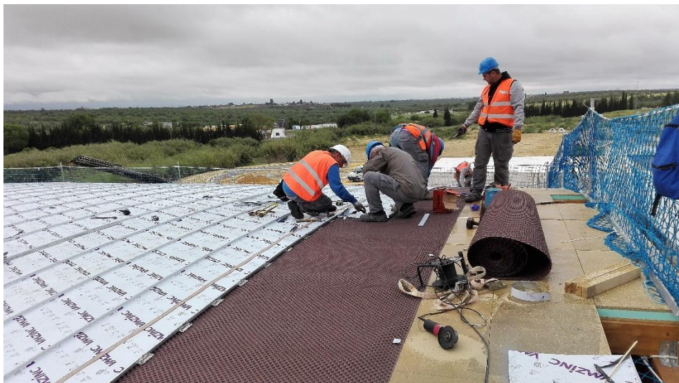
Ilustración 27 - Vista colocación y fijación de lámina nodular. Capilla CEU Bormujos, Edificio objeto de estudio. Fuente: Elaboración propia.
