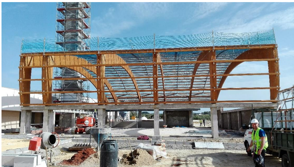
Ilustración 13 - Vista fase de estructuras, trabajos de urbanización. Capilla CEU Bormujos, Edificio objeto de estudio. Fuente: Elaboración propia.
