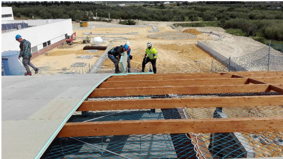
Ilustración 19 - Vista colocación de paneles tras varias m2 ya ejecutados. Capilla CEU Bormujos, Edificio objeto de estudio. Fuente: Elaboración propia.
