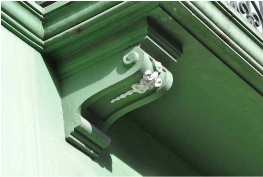
Fig. 8 Ménsula de balcón del edificio nº 73 de la calle Calvario. La Orotava
