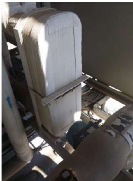
Figura 2.9. Intercambiador de calor.
