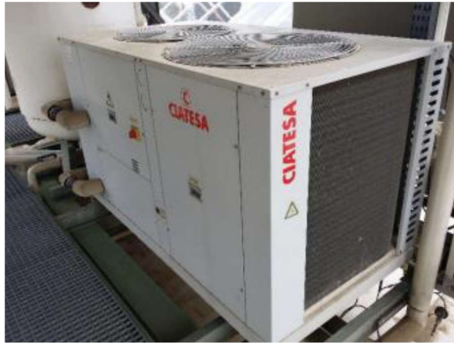
Figura 2.8. Bomba de calor.
