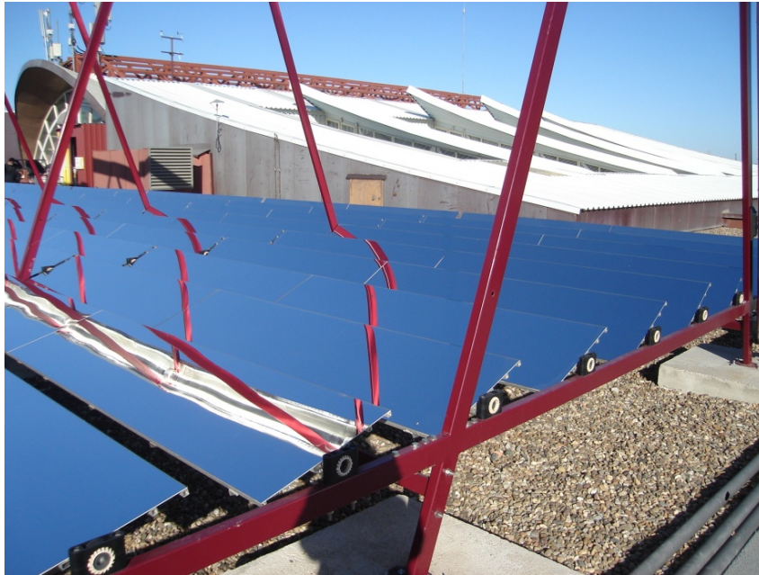
Figura 4-4 Espejos reflectores en modo funcionamiento
