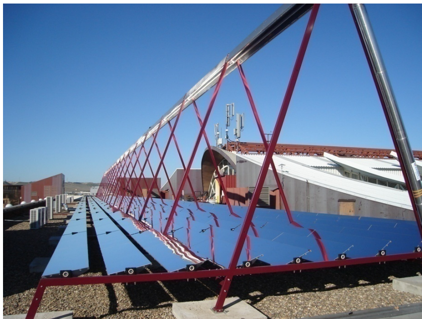
Figura 4-2 Imagen de la instalación situada en la azotea
