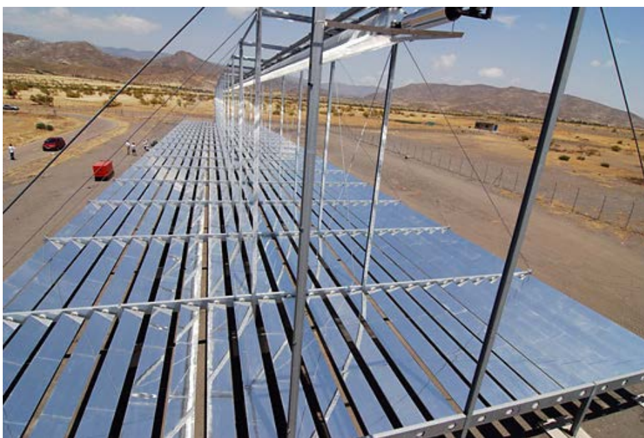
Figura 3-8 Colector solar lineal Fresnel instalado en Almería (PSA)
