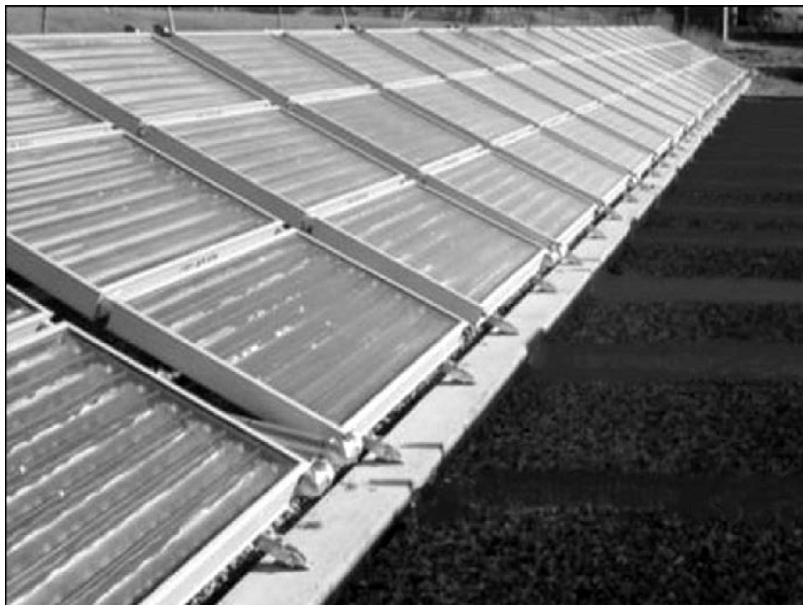
Figura 3-3 Paneles de colectores parabólicos compuestos
