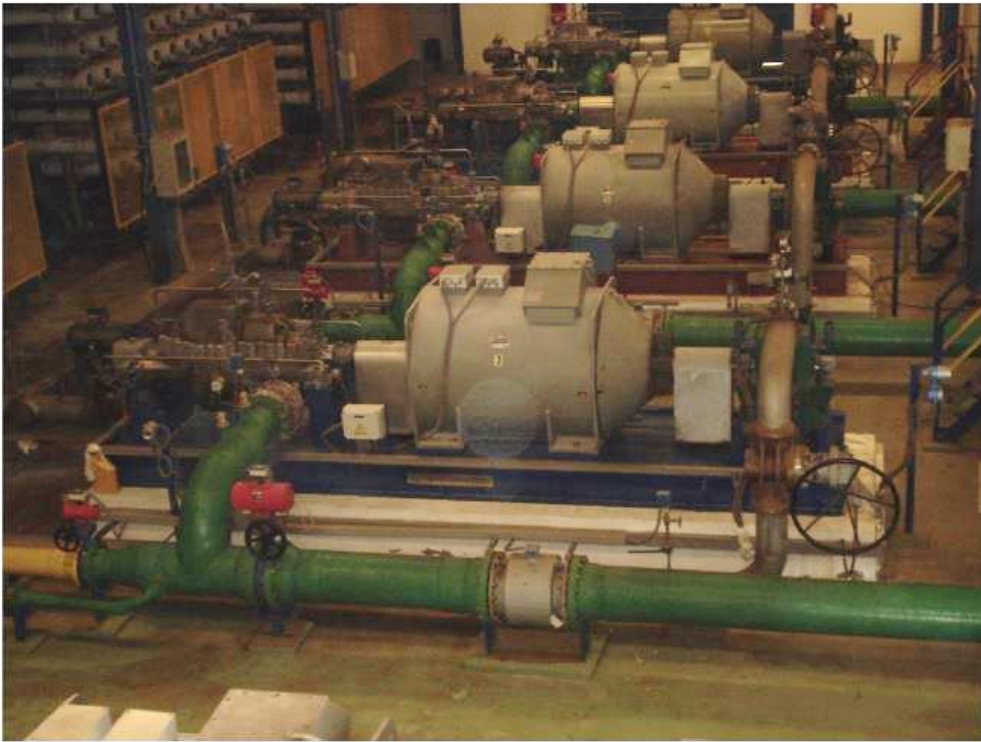
Figura 4.2: Bombas de alta presión y turbinas Pelton de la planta Lanzarote IV. Fuente: Inalsa
