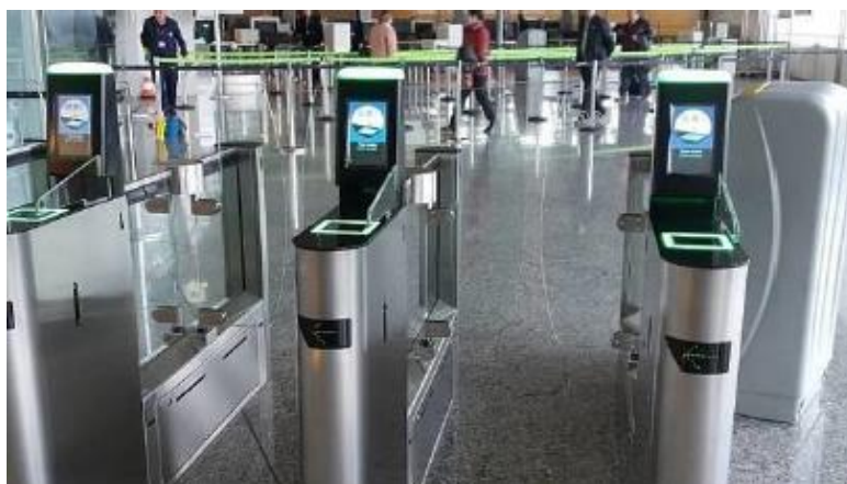
Imagen 11-5. Dispositivo de acceso automático a control de seguridad. El diario Deia
