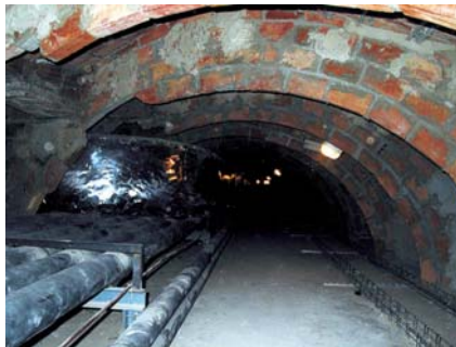
Figura 21. Redes de tuberías por cámaras de cubierta.
