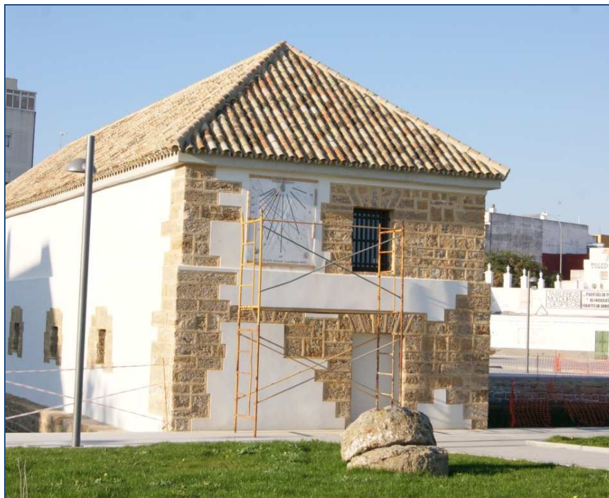
F. 2: Ejemplo de restauración (edificio del siglo XVIII) alejada de los criterios de intervención. Adición de un reloj de sol sin que haya constancia ni documentación que demostrara su existencia.
