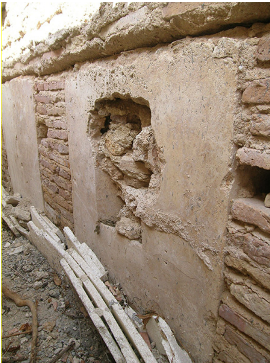
Ilustración 06. Estado de conservación de uno de los merlones del lienzo Oeste del Castillo de San Romualdo antes de la intervención.
