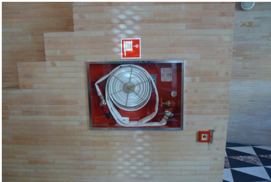
Ilustración 21: sistema contra incendio de la sala
