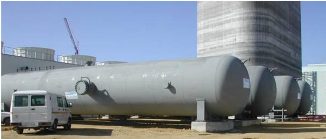
Ilustración 25 Acumuladores de vapor de la PS10
