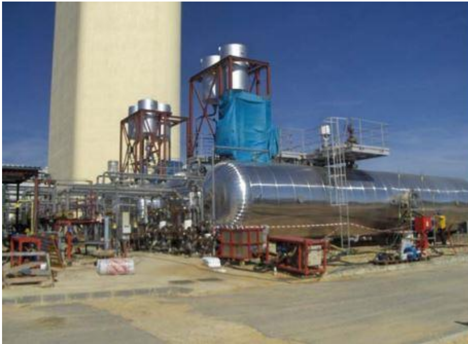
Ilustración 11 Acumuladores de vapor de la PS10
