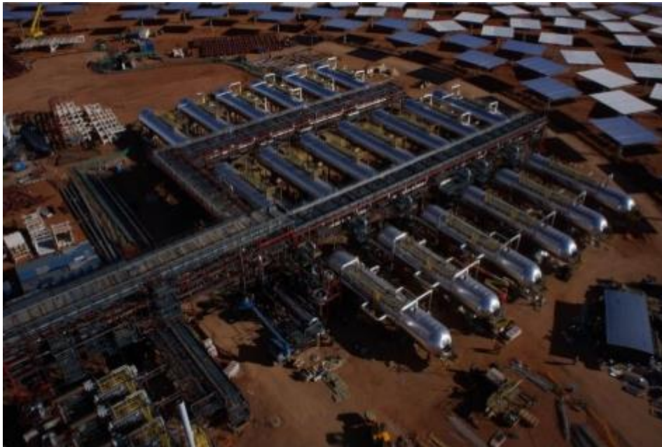
Ilustración 20 Sistema de almacenamiento Khi Solar One
