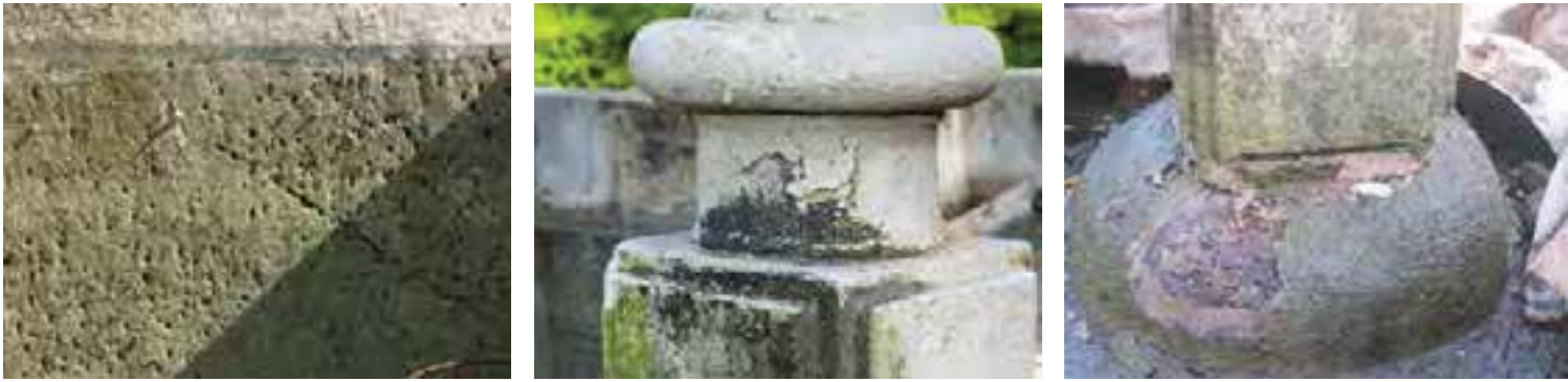
Figura 12. Daños de tipo biológico: a. Microcavidades producidas por la acción de algas y cianobacterias. b y c Costras estromatolíticas (superficie carbonatada y endurecida bajo la que se alternan estratos de biofilm mezclado con materia inorgánica sin compactar).
