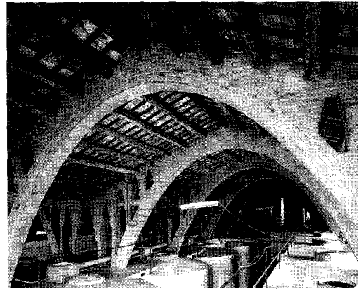
Figura 12 Las tres primeras hiladas de rasilla construidas sin cimbra sirven de soporte a las siguientes. Bodega de Nulles. César Martinell (1919).
