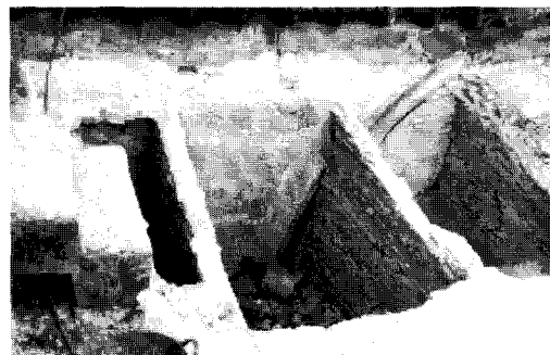
Figura 8 Alcatifa mixta en la bóveda de la capilla de la Virgen de la Antigua. Empalmado del siglo XVIII y vasijas recolocadas, procedentes del relleno original de 1512
