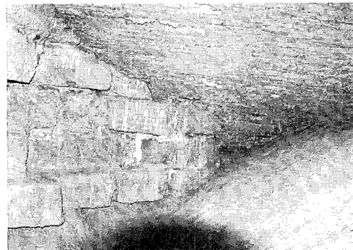
Figura 2 Interior de la bóveda secundaria de ladrillo. Se observa el apoyo en los muros laterales y el trasdós
