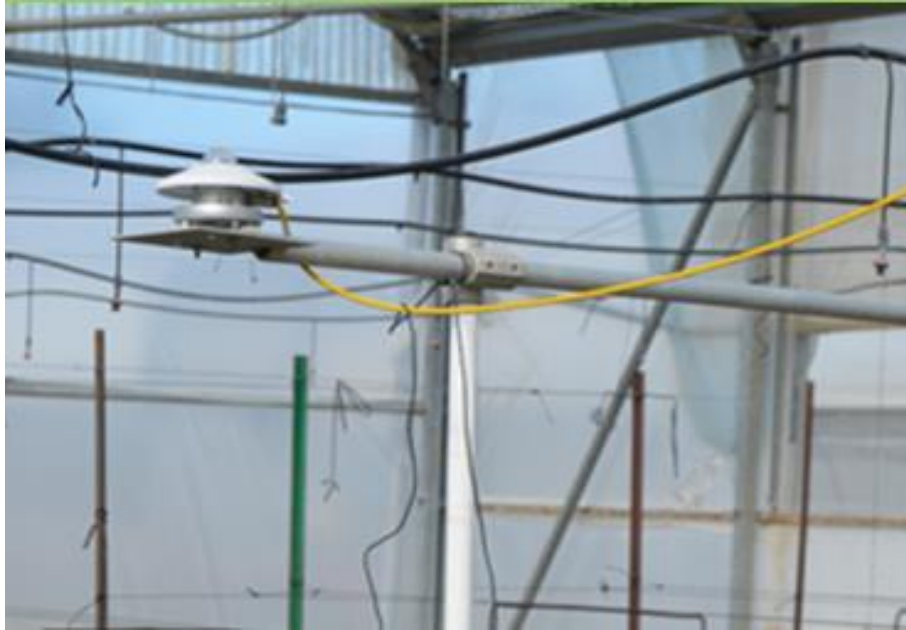
Imagen 13. Detalle de uno de los piranómetros instalados en el invernadero.
