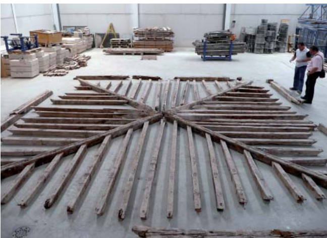
Replanteo y comienzo de la restauración de la armadura de madera del presbiterio.
