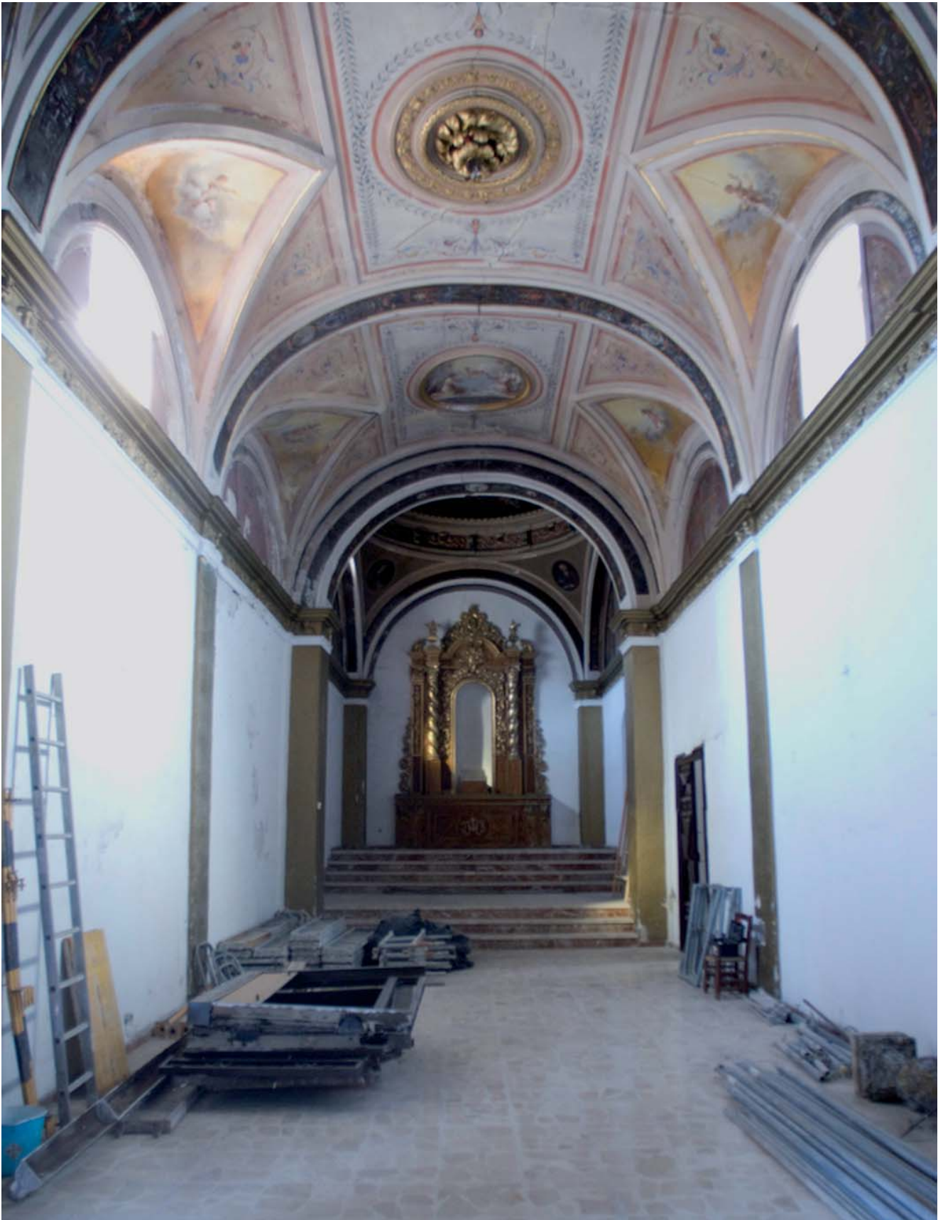
La Capilla de Jesús en noviembre de 2008 antes del inicio de los trabajos. Se observa como las sucesivas reparaciones y operaciones de mantenimiento habían desnaturalizado el ambiente de la Capilla haciéndolo irreconocible y dividiendo el espacio en dos mitades a la altura de la cornisa: por un lado la parte de las bóvedas y por otra la zona de las paredes y suelo, parecían no tener nada que ver entre sí.
