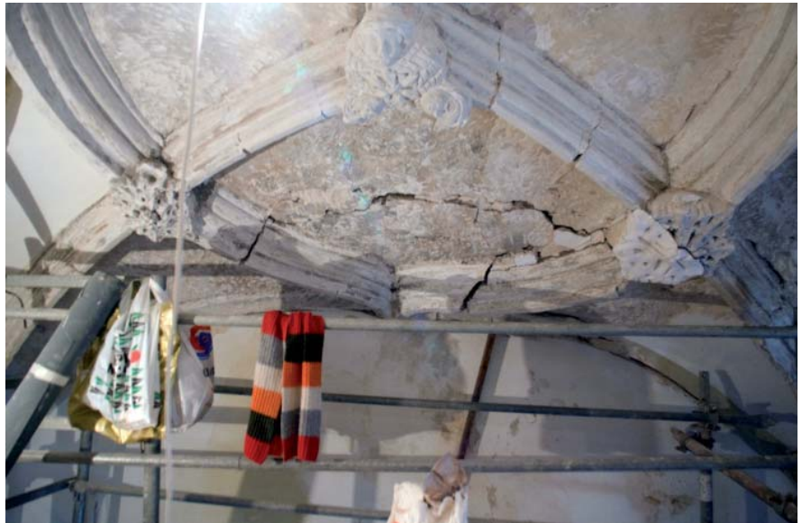
Estado en el que se encontró la bóveda gótica al eliminar la espesa capa de pintura y yeso que la recubría. Como el resto de las bóvedas de la Capilla, se trata de una bóveda encamonada, es decir, no es portante, ni de piedra o sillares, sino que sus nervios principales son de yeso negro y su plementería una rosca de ladrillo macizo recubierto con yeso y forrado en el trasdós con escayola y un armazón de madera. Como se observa se encontraba en un pésimo estado de conservación.
