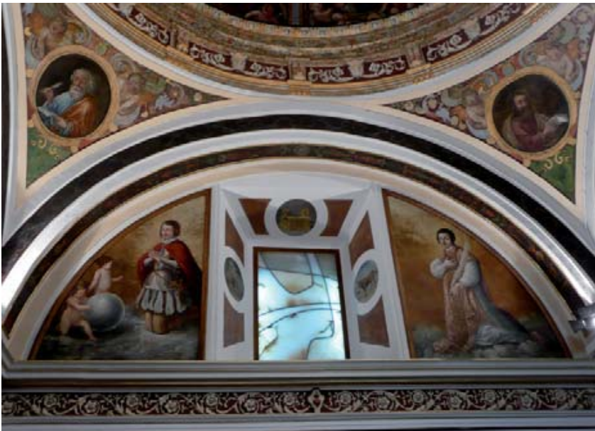
Luneto del lado derecho del presbiterio con las figuras orantes de San Fernando y San Amador. En la foto superior el estado en el que se encontraba antes de iniciar su restauración. En la foto inferior el luneto una vez restaurado. La vidriera de esta ventana ha sido realizada en alabastro aragonés en los talleres de San Juan de Mozarrifar (Zaragoza) y es una donación a la Capilla de Santiago Quesada.
