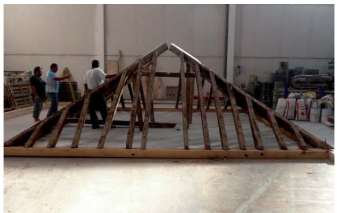
Montaje en seco de la armadura sobre los nuevos estribos y antes de la colocación de los nuevos pares de madera y del pendolón como pieza de encuentro de las limas de esquina.
