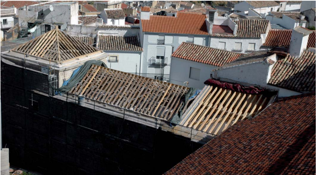
Aspecto de todas las armaduras de la Capilla, una vez resanadas y restauradas. El encuentro de las limas incorpora la nueva pieza del pendolón, elemento que no existía (o no se encontró) en las originales y que se creyó conveniente introducir para darle más robustez a la estructura. Todas las piezas nuevas fueron marcadas con la fecha de su colocación.
