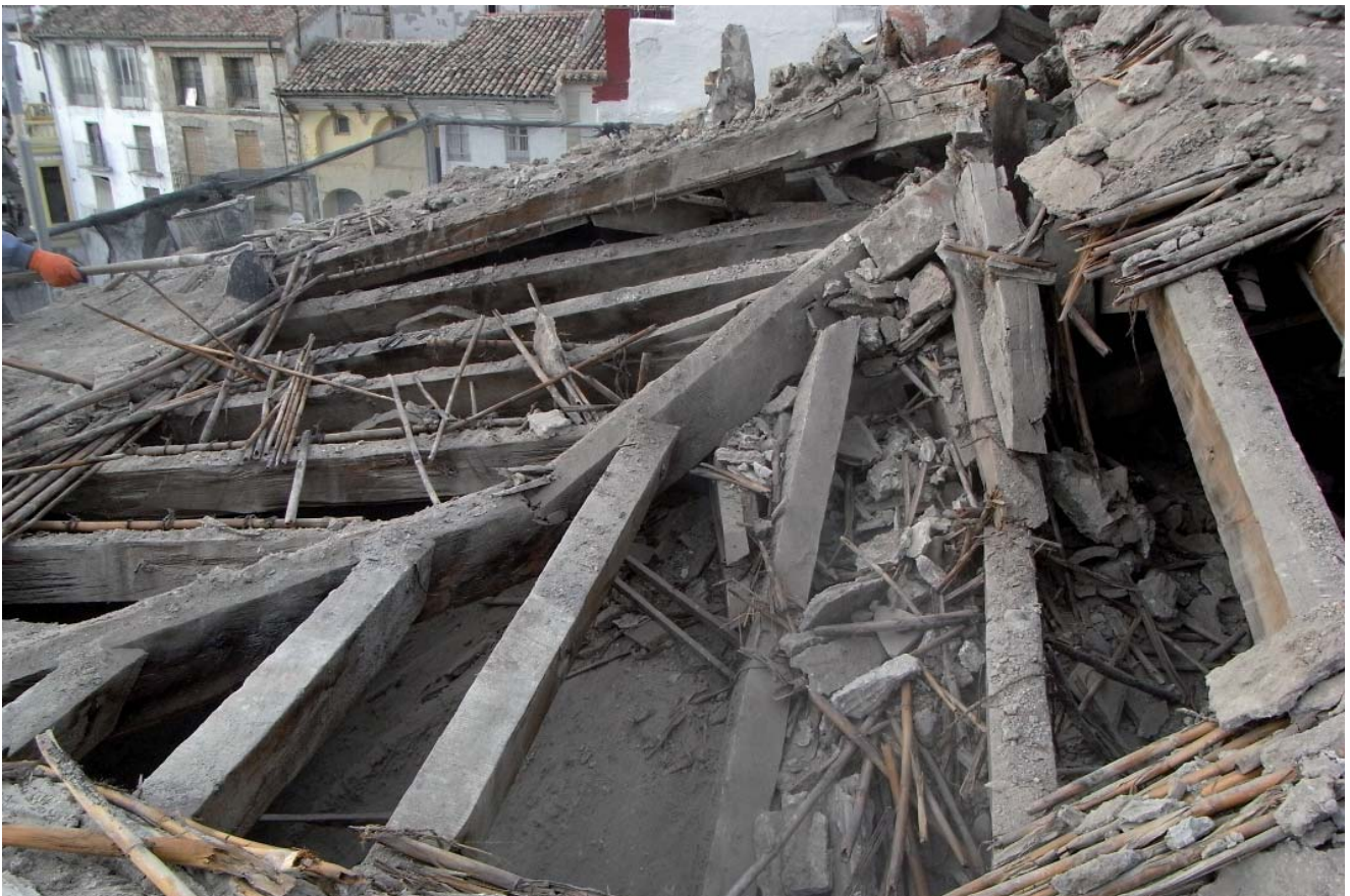
Estado en el que quedó la cubierta del presbiterio tras su colapso en el verano de 2008.
