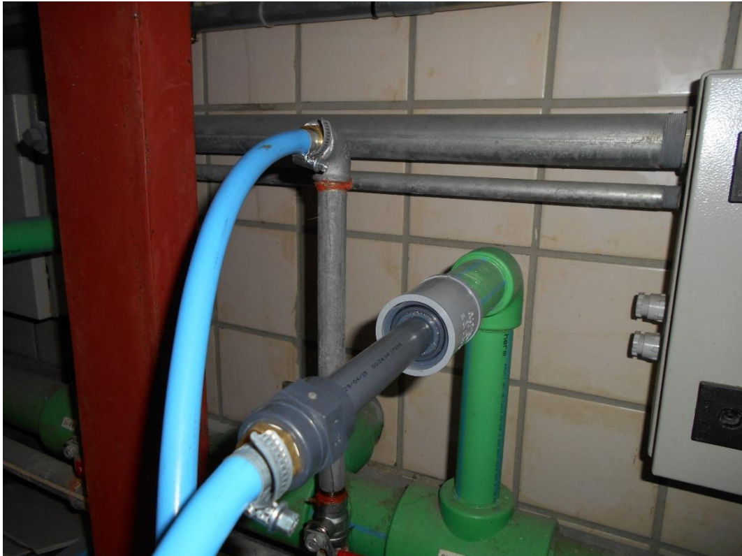
Foto 16. Alimentación y desagüe de agua de refrigeración
