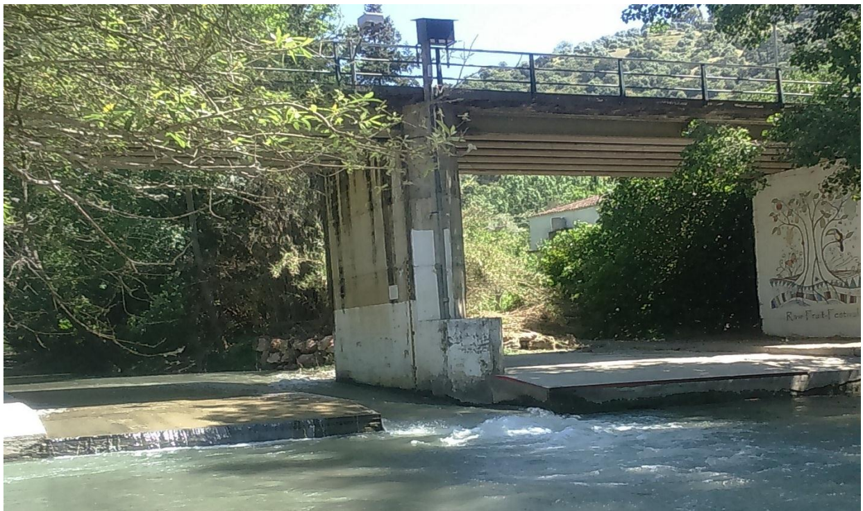
Estación de aforo de Puente Jubrique tomada aguas abajo del río.
