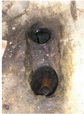
Foto 12. Pozos de decantación
