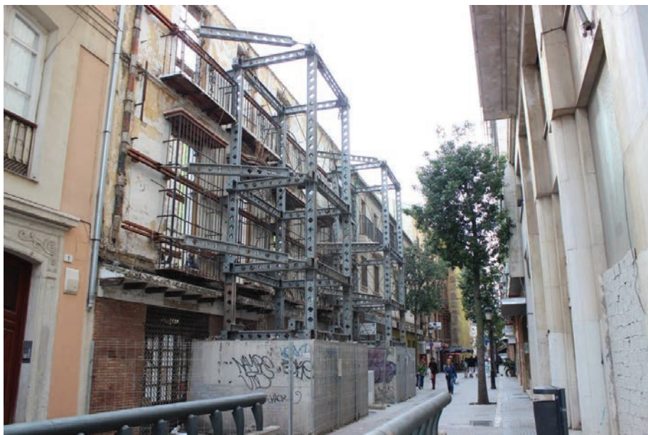
Figura 3. Estado de conservación de la edificación protegida en calle Casas de Campo. Fuente: Lourdes Royo Naranjo. 2014. Imagen de 2013.
