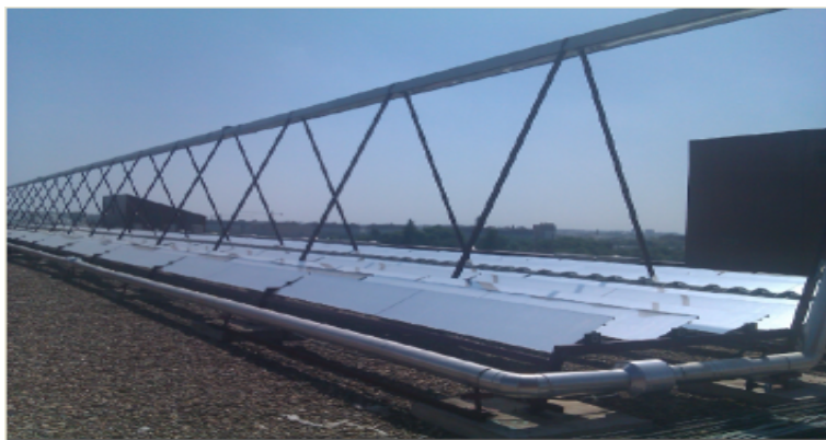
Figura 6.2: Campo de colectores Fresnel
