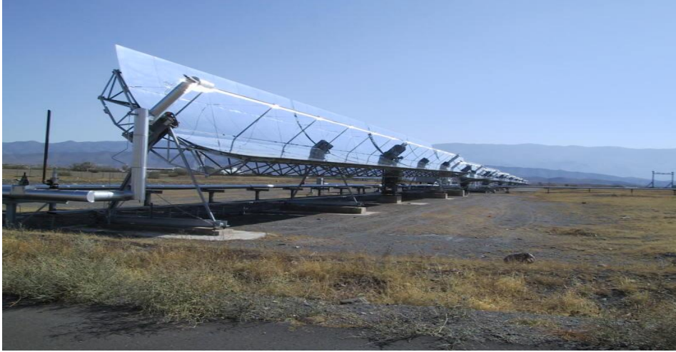
Figura 1.1: DISS de colector cilindro-parabólicos en la Plataforma Solar de Almería
