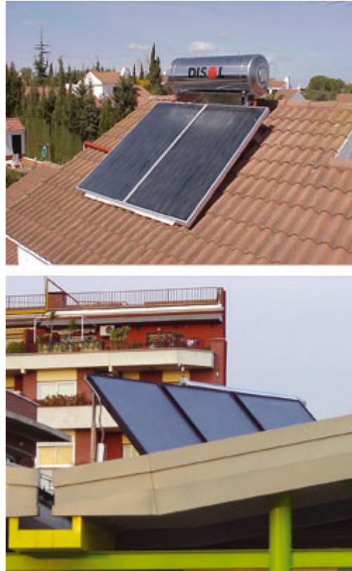
Figura 4-11. Colectores solares con depósito integrado.
