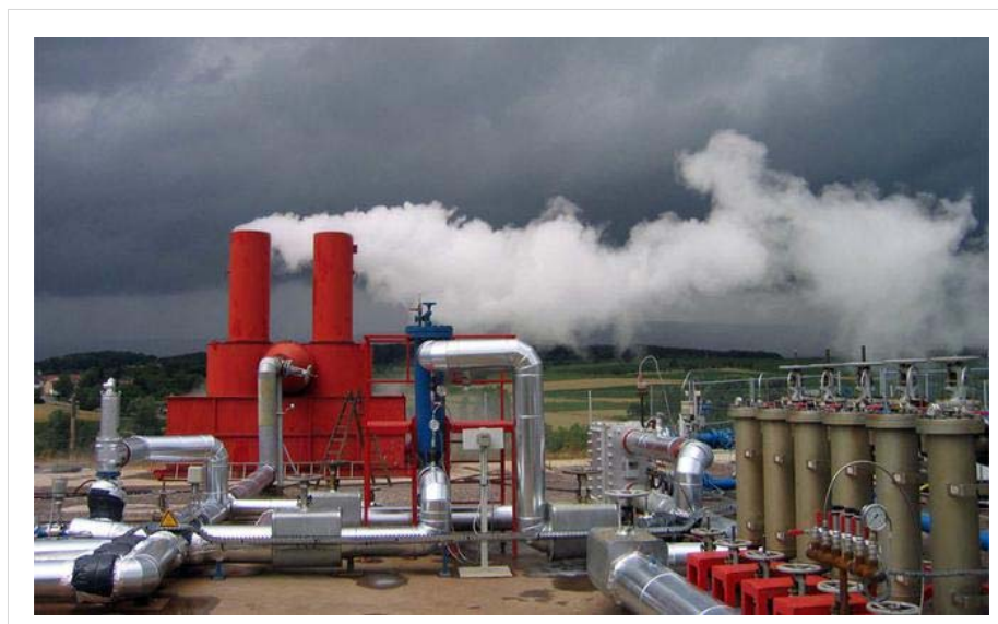
Figura 2-4. Central de Soultz-sous-Forêts en Francia. / BRGM-ADEME
