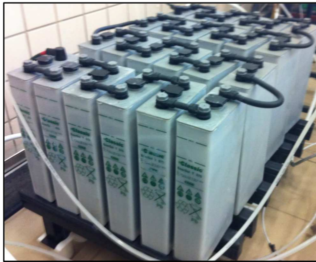
Figura 3.3.5.1 Banco de baterías plomo-ácido del laboratorio de hidrógeno
