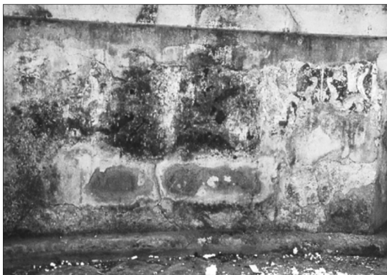
Pinturas almohades del jardín del Patio Musulmán de la Consejería de Obras Públicas y Transportes de Sevilla
