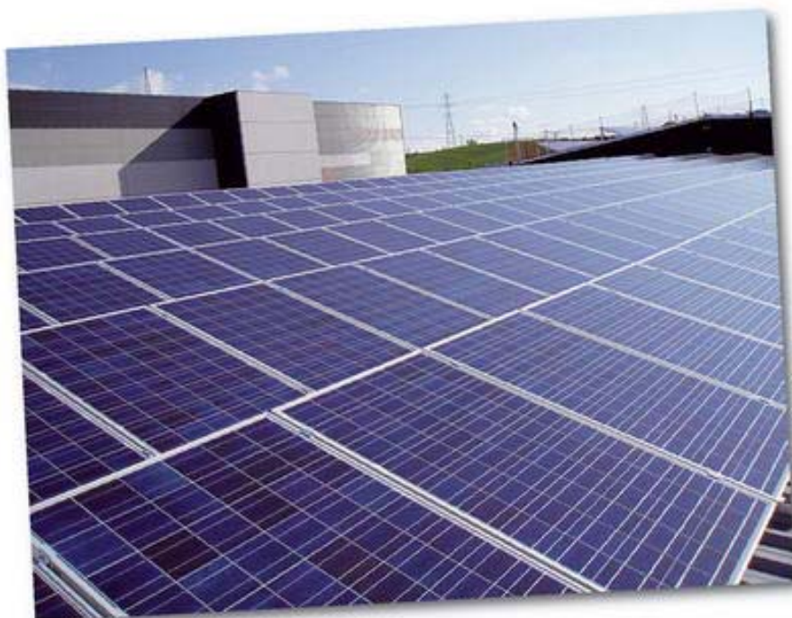
Figura 4. Cubierta de paneles solares.
