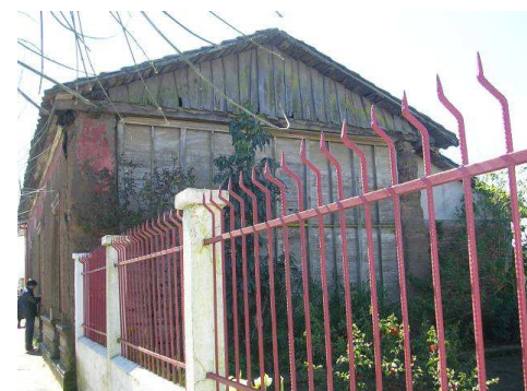
Lateral casa Violeta Parra sin muro de arriostramiento
