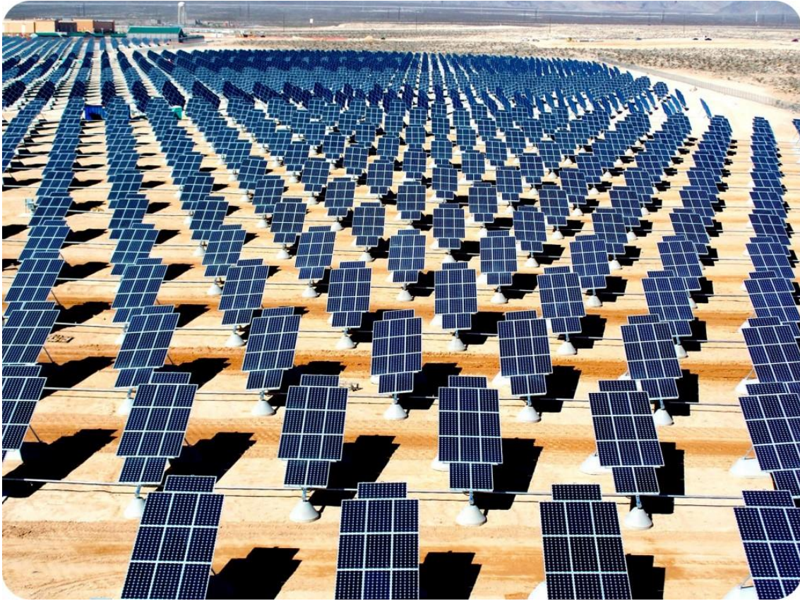
Figura 33. Parque de paneles fotovoltaicos
