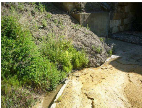
El deslizamiento ha producido la ocultación parcial de una fachada del anfiteatro romano
