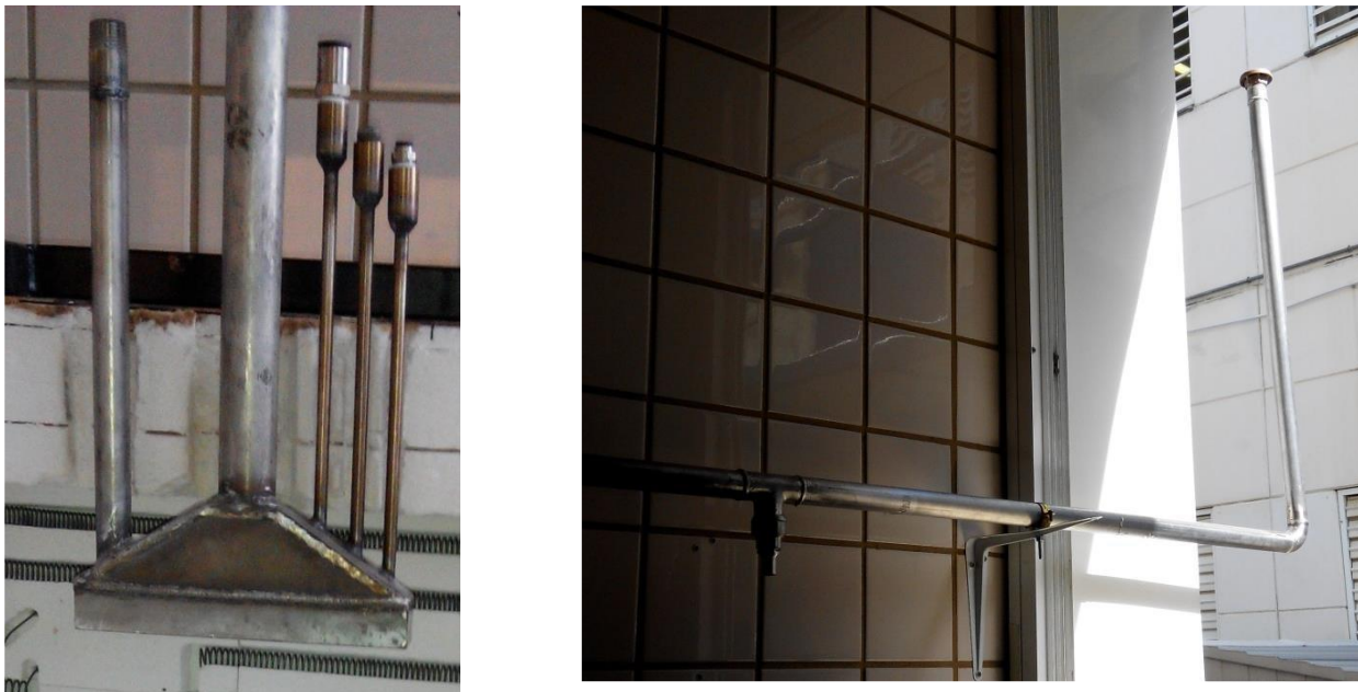
Figura AI.2. Colector y tubería de expulsión de gases
