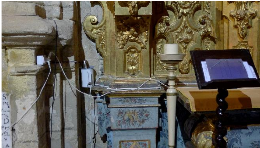
Fig. 3 - Detalle de la instalación eléctrica anclada en la estructura del retablo. Obsérvese la disposición del hervidor de agua de uso habitual. Iglesia de Santo Domingo. Sanlúcar de Barrameda, Cádiz, 2015. (Fotografía de la autora)
