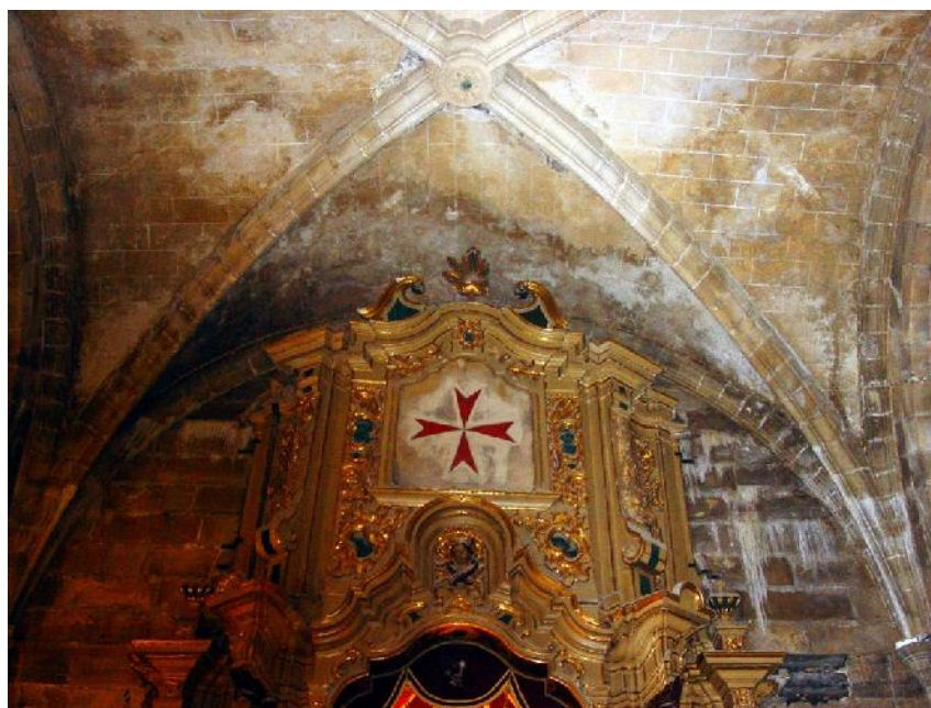
Fig. 4 - Detalle del ático del Retablo de Nuestra Señora de Belén. Catedral de Jerez de la Frontera. Son visible las manchas de humedad y las eflorescencias salinas consecuencia de las infiltraciones de humedad procedentes de la cubierta y de los sistemas de evacuación de aguas pluviales que influyen negativamente en los elementos de madera existentes en su reverso, 2014.
