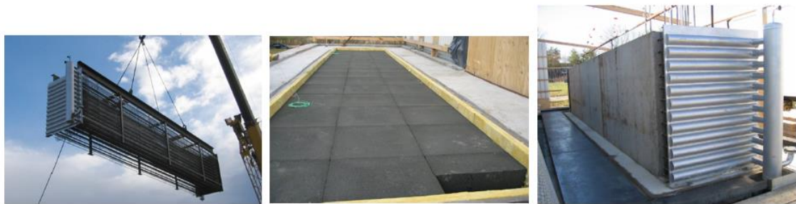
Ilustración 46 Registro de tubo, base térmica y módulo finalizado y colocados del proyecto Stuttgart respectivamente [Laing, 2008]
