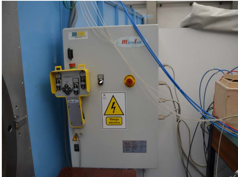
Figura 0-6. Panel eléctrico del sistema de cambio de ángulo de ataque
