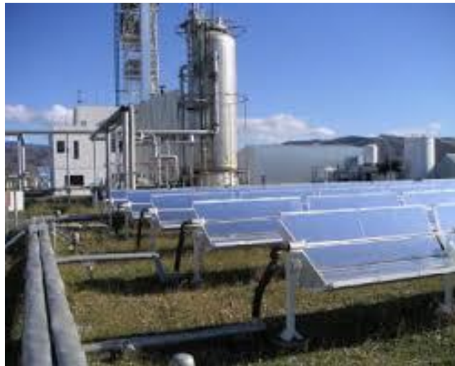
Figura 3-1 Campo de colectores distribuidos ACUREX de PSA (cortesía de PSA)
