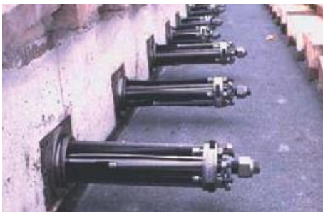
Fig. 61. Iglesia de San Francisco de Asís. Italia. Sistema de disipación de energía y control de deformaciones mediante mecanismos de aleaciones SMA
