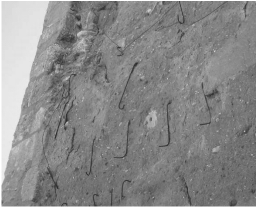
Figura 2. Barras de acero oxidadas y desprendimientos.
