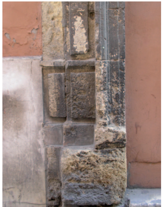
Costras negras en el basamento de la pilastra izquierda de la portada lateral de la iglesia de San José. Debajo, detalle del grado de disgregación y arenización de la roca. Fotos: P. Ortiz, M. S. Abad
