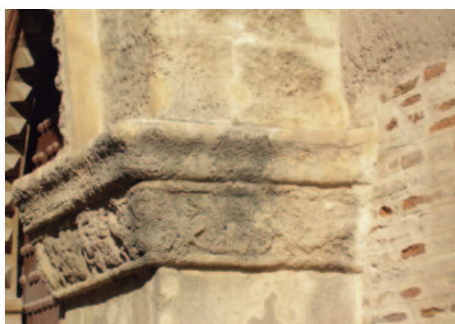
Restos de depósitos y costras en la imposta de la fachada de San Marcos
