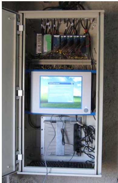
Figura 4. Armario de control con el autómata programable, ordenador industrial y sistema de alimentación ininterrumpida (SAI).
