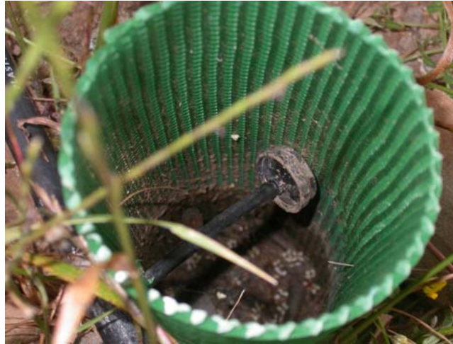
Figura 1. Sistema de riego subterráneo RA
