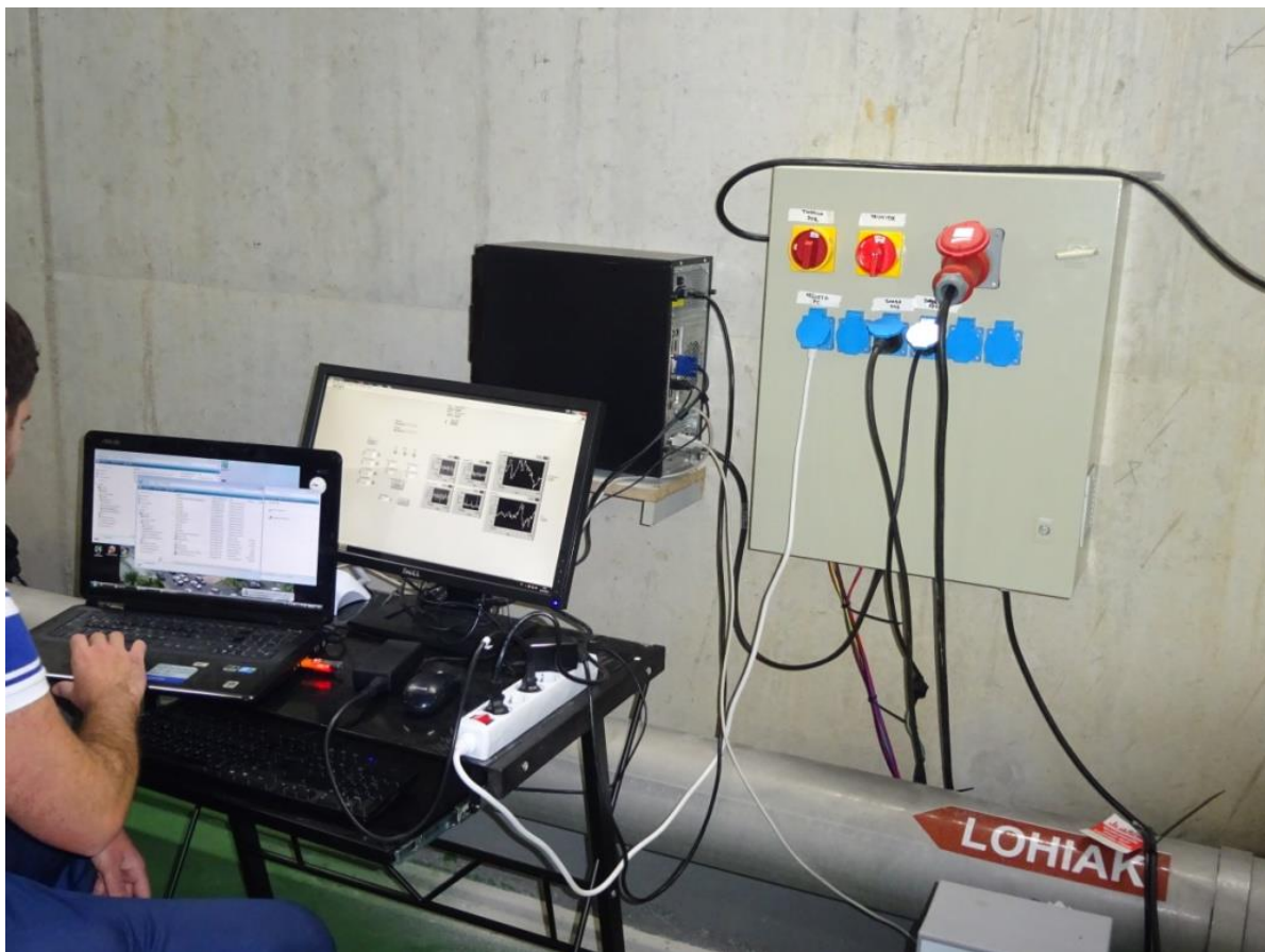
Figura 2.25. Puesto y PC de control y cuadro eléctrico
