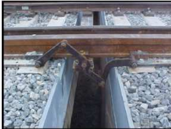
Figura 1 Aparato de dilatación de vía en un puente de ferrocarril
