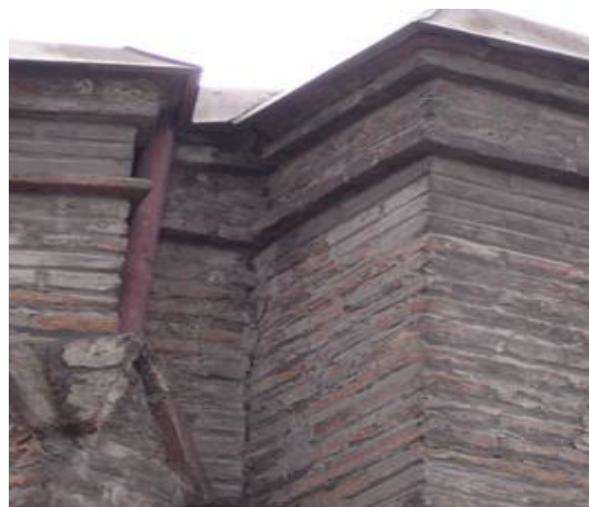
Fotografía 26. Grieta de corte vertical. Ed Autor.
