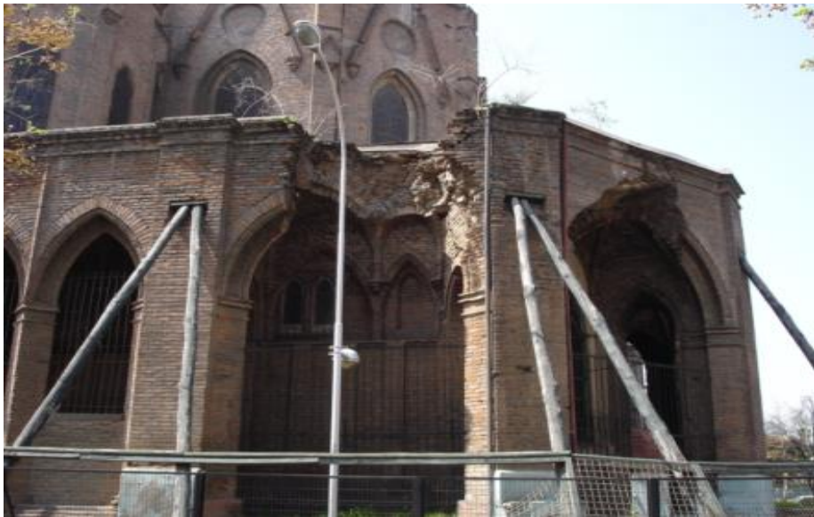
Fotografía.2: Daños estructurales en fachada sur-poniente producto del terremoto de 1985 6 .
