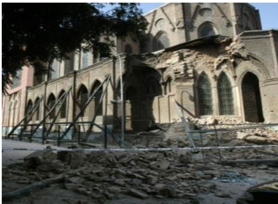
Fotografía.5: Vista fachada sur-poniente luego del sismo del año 2010 9 .
