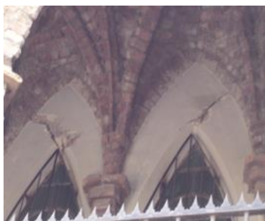
Fotografía 16. Grietas de corte diagonal. Ed. Autor
