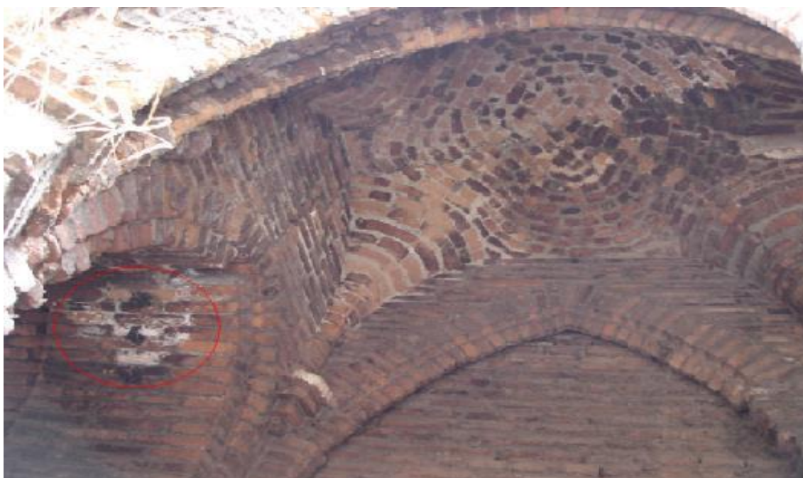
Fotografía 13: Eflorescencias detectadas en la Basílica del Salvador 46 .
