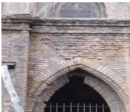
Fotografía 22. Grieta de corte en sentido vertical. Falla de adherencia del mortero pega. Ed Autor.
