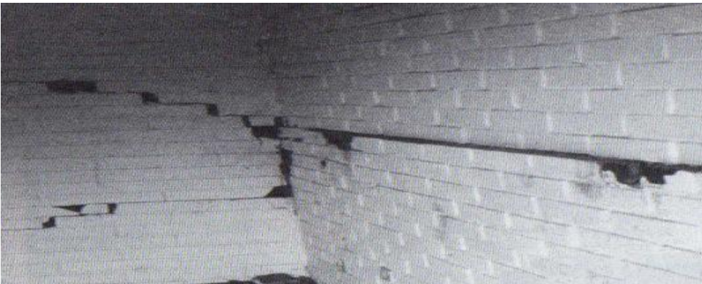
Fotografía 8: Ejemplo de un muro de albañilería fisurado por corte en sentido horizontal y vertical. Después de una sollicitación sísmica en el año 1985 37
