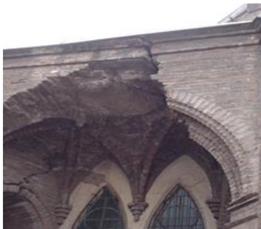
Fotografía 20. Grieta de corte vertical en la albañilería y grieta pasante. Ed. Autor.
