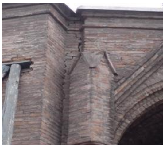
Fotografía 24. Grieta de corte vertical. Ed Autor
