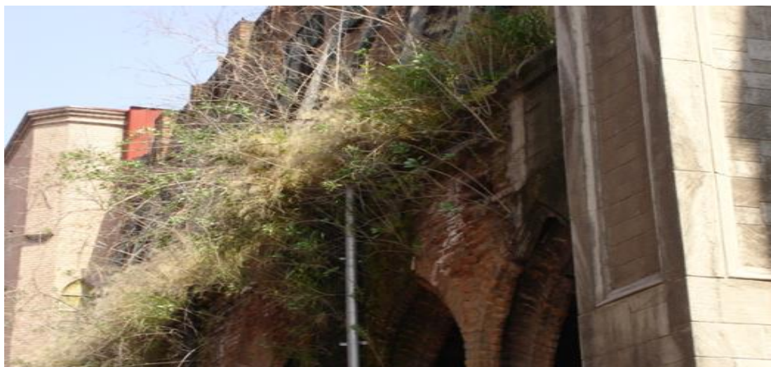
Fotografía 12: Presencia de patología por acción biológica en fachada Este 44 .
