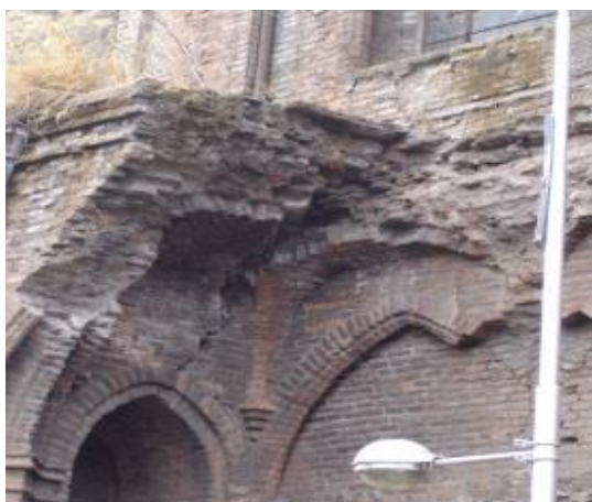
Fotografía 21. Grieta de corte vertical y pérdida del elemento estructural. Ed Autor.
