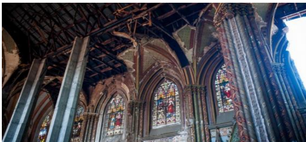
Fotografía 10: La Basílica del Salvador, vista interior, pérdida de cielo y muros laterales. Después del sismo 2010. 41
