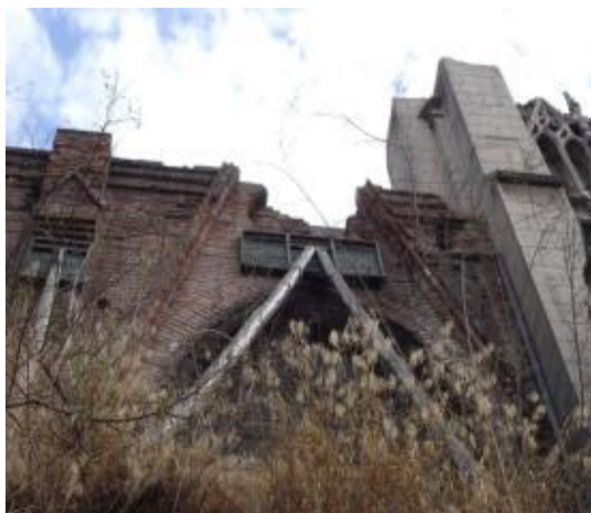
Fotografía 19. Daño en extremo superior: Grieta pasante. Ed Autor.
