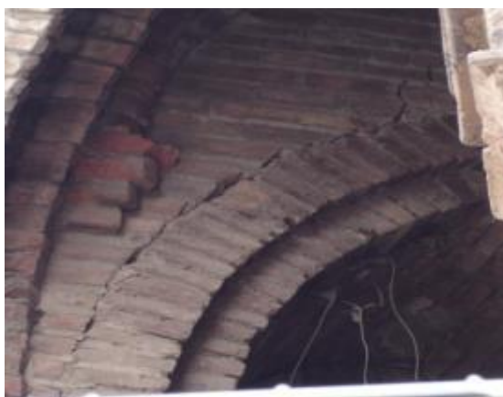
Fotografía 15. Grieta de corte en sentido vertical: Falla por adherencia del mortero. Ed Autor.
