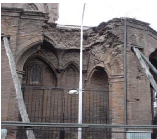
Fotografía 23. Grieta pasante en sentido vertical. Pérdida del arco. Ed Autor.
