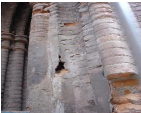
Fotografía 17. Grietas y fisuras con daños superficiales en el ladrillo. Ed. Autor
