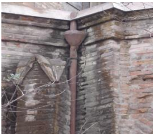
Fotografía 25. Grieta de corte vertical. Ed Autor.
