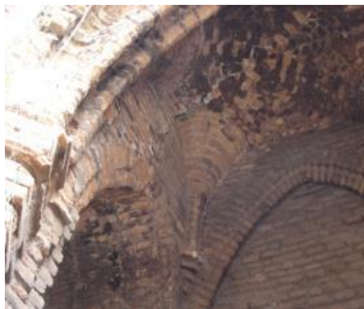
Fotografía 18. Grieta de corte en sentido vertical Ed. Autor
