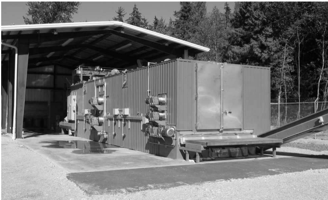
Figura 1.8: Instalación con túnel dinámico
